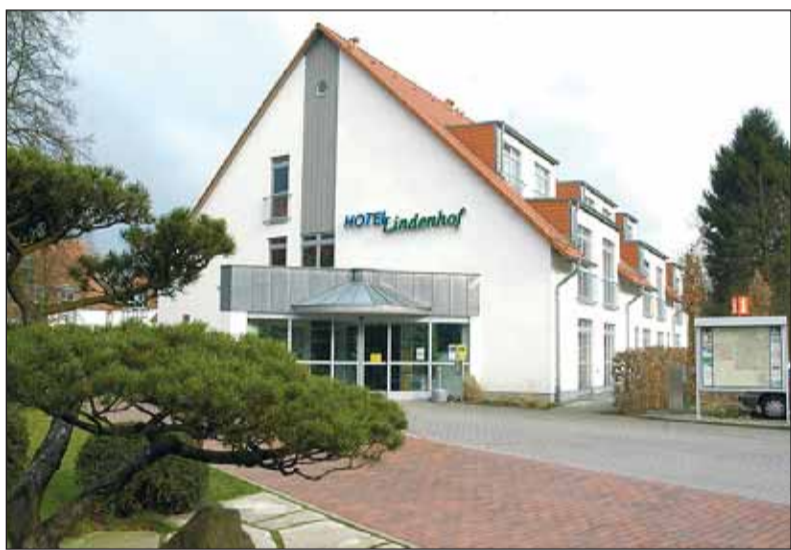
Lindenhof: Ausbildungshotel und Vorzeigebetrieb. Seit Februar versorgt ein eigenes Blockheizkraftwerk das Haus. Foto: Markus Poch
