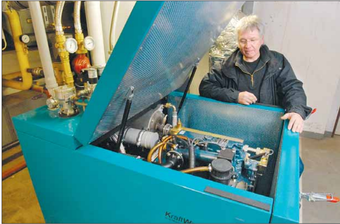
Hausmeister Dieter Herms mit dem technischen Diesel gleichzeitig Strom und Abwärme, die man für die Heizung des Hotels nutzt. Fotos (2) Bernhard Pierel
