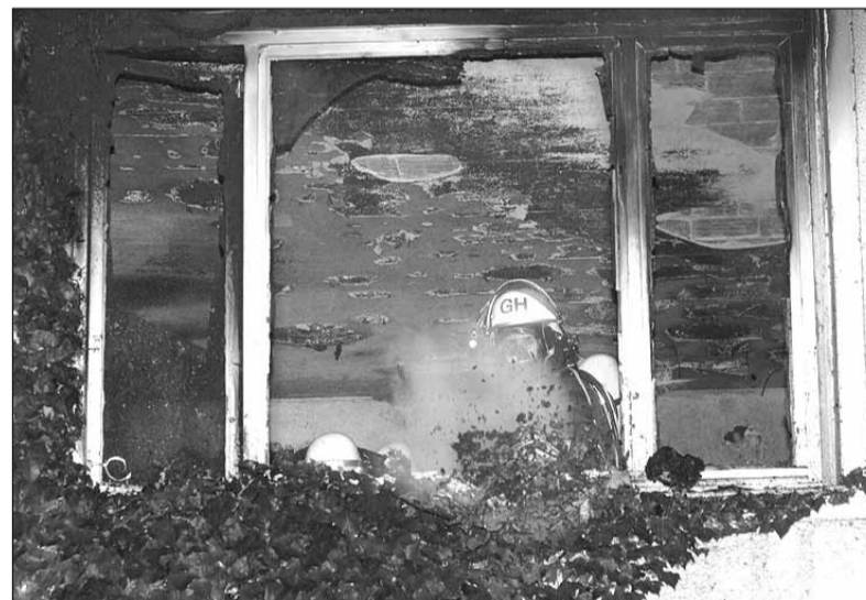
Unbewohnbar: Das Feuer hatte so eine Hitze entwickelt, dass in der Brandwohnung der Putz von Decken und Wänden abgeplatzt war.
